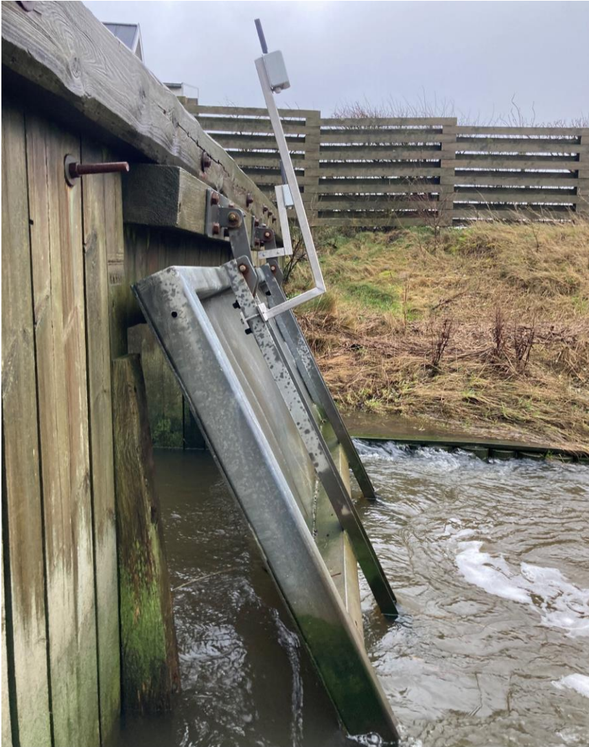
Figur 6: Højvandsslusen i Vestervig Å med påmonteret tilt-censorer. Foto taget den 18. januar 2023, som er en af de situationer, hvor slusen har været meget åbent, ca. 80 cm.
